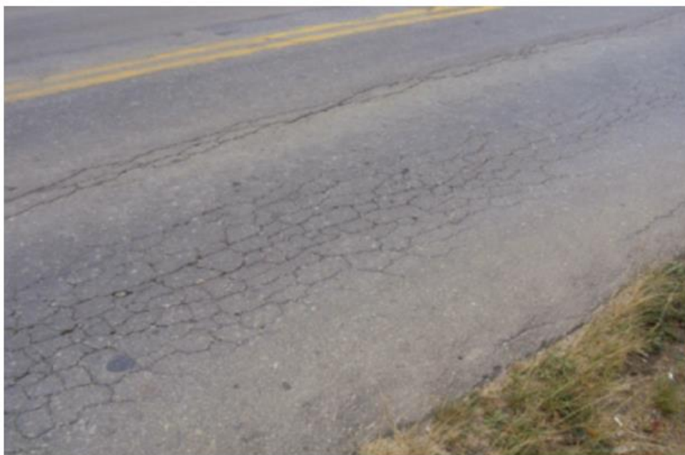
Figura 11: Trincas do tipo “couro de jacaré” (interligadas) Fonte: Manual Básico de Estradas e Rodovias Vicinais V. II (Conservação)
