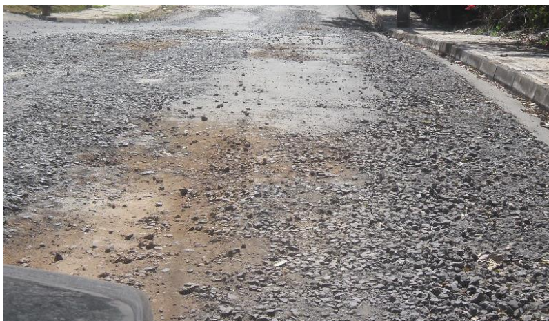
Figura 16: Desagregação do agregado no pavimento e panelas Fonte: ARIA
