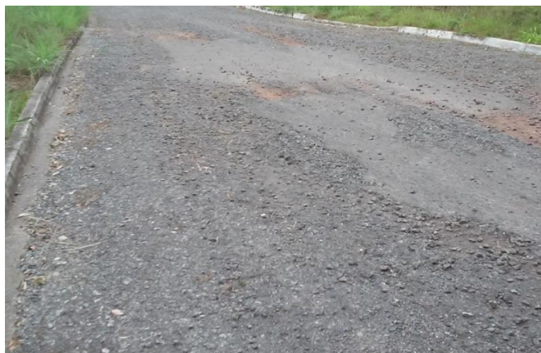
Figura 15 :Desagregação do agregado no pavimento e painelas Fonte: ARIA
