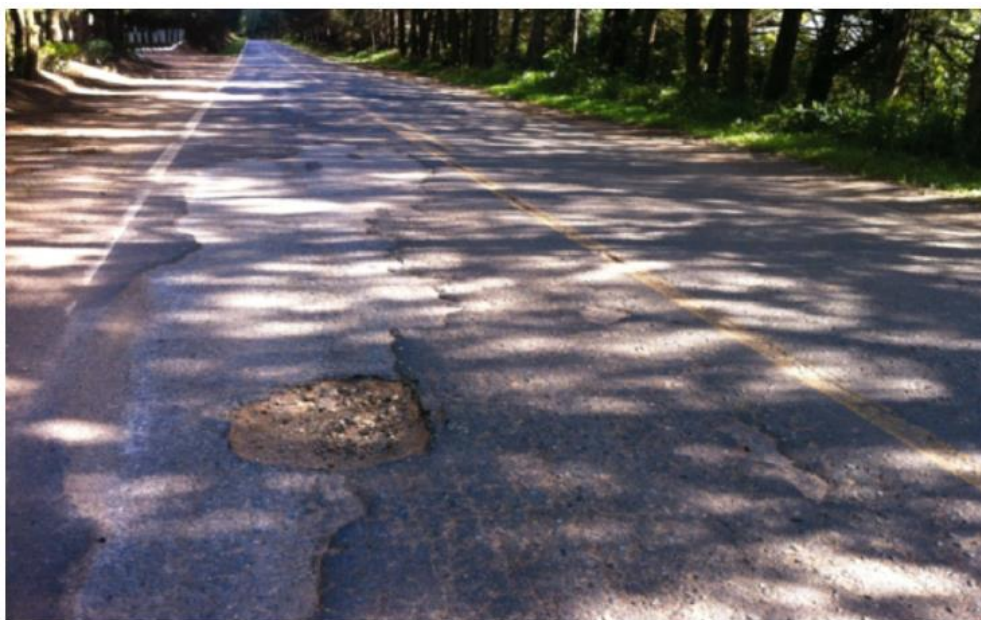
Figura 14: Buraco no pavimento
