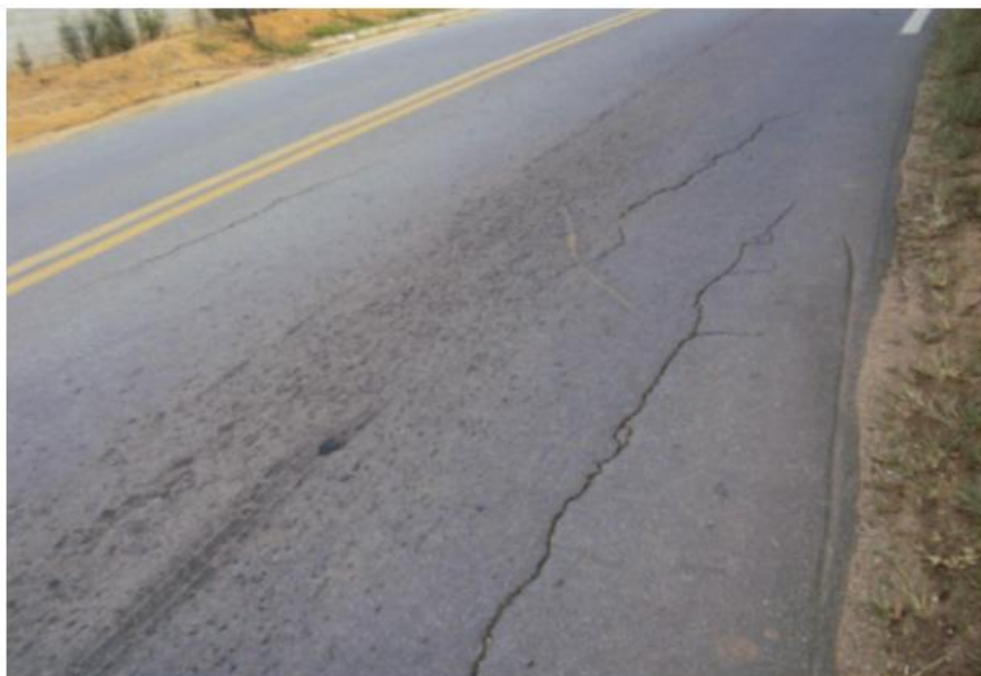
Figura 12: Trincas isoladas no revestimento asfáltico Fonte: Manual Básico de Estradas e Rodovias Vicinais V. II (Conservação)
