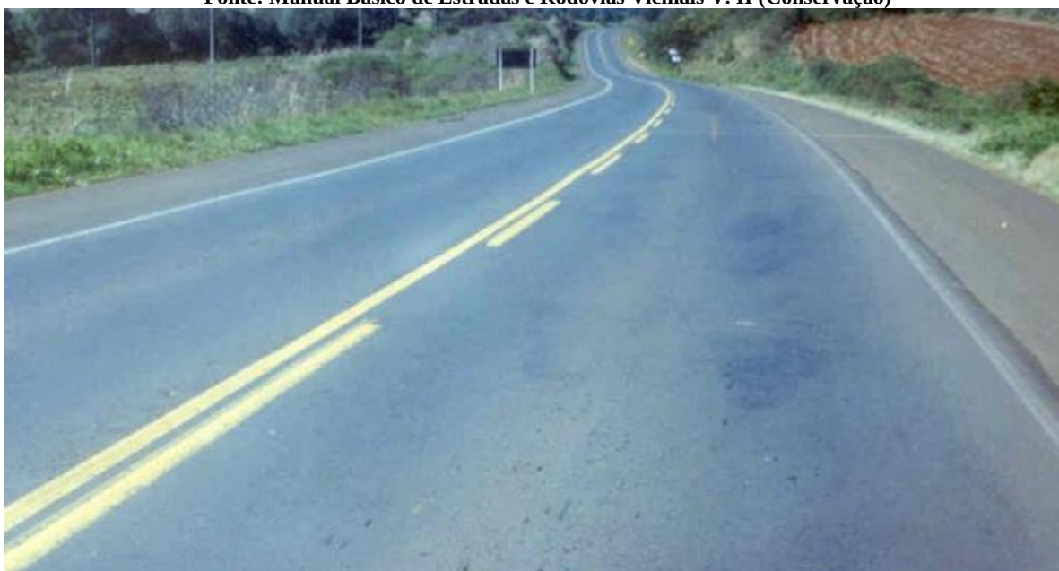
Figura 10: Exsudação do ligante no revestimento
