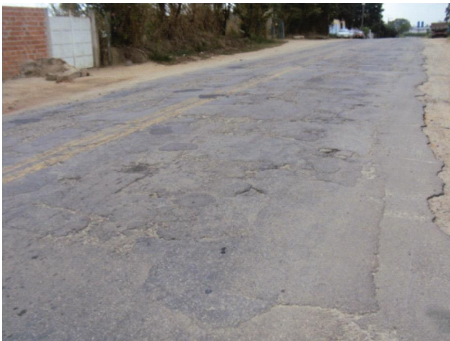
Figura 5: Defeitos no revestimento asfáltico de um pavimento Fonte: Manual Básico de Estradas e Rodovias Vicinais V. II (Conservação)
