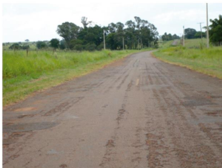
Figura 8:Desagregação do agregado no pavimento Fonte: Manual Básico de Estradas e Rodovias Vicinais V. II (Conservação)
